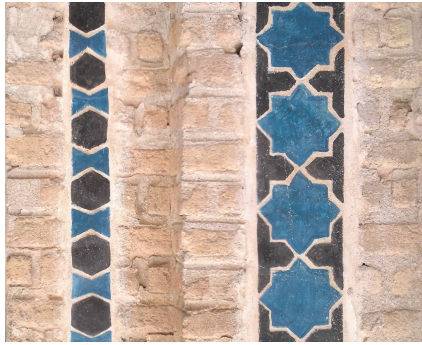
Fotoğraf-5: Cemal Ali Dede Türbesi ön cephe, özgün çinilerin yerine restorasyon sonrası yapılmış boya uygulamaları.
